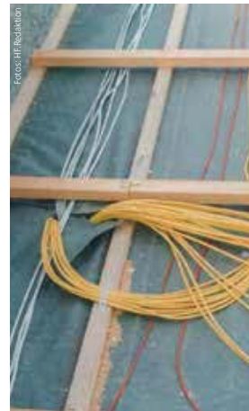
Bei der Kabelführung dieser Solaranlage ist dem Eindringen von Wasser Tür und Tor geöffnet
