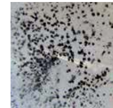
Werden die Ursachen nicht fachgerecht beseitigt, bricht Schimmel schnell erneut aus
