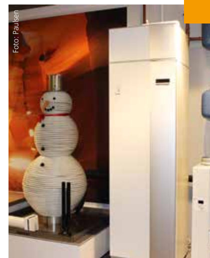
Wärmepumpe in Funktion – am Schneemann wird in der Ausstellung das Prinzip der Anlage erklärt
